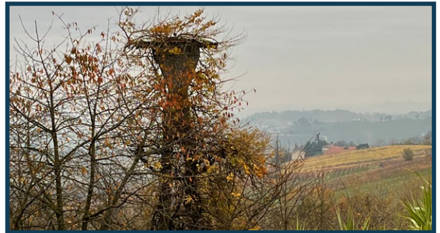
Traliccio della teleferica Bargerò completamente ricoperto da vegetazione e visibile solo dopo la caduta del fogliame
